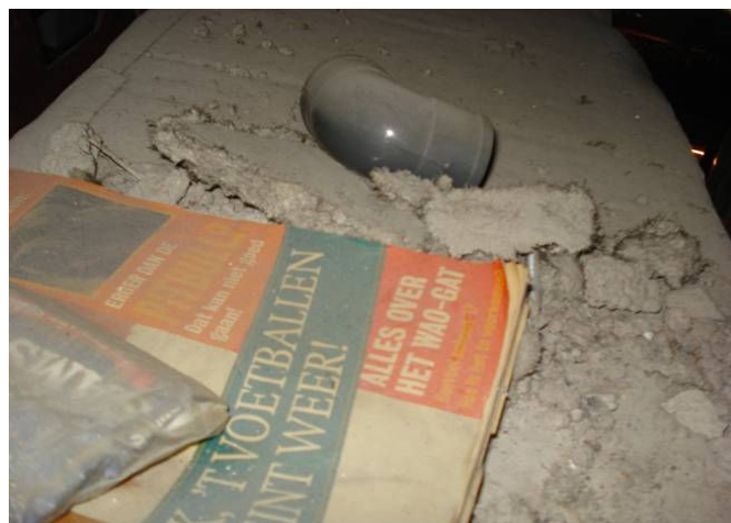
Figuur 5-2: Spuitasbest, met veelal amfibool (amosiet of crocidoliet) asbestvezels die gemakkelijk los komen van de matrix, in 2009 aangetroffen in een gebouw dat rond 1994 is gesaneerd (foto ter beschikking gesteld door BME Asbestconsult B.V.).
